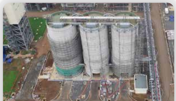
Silo Abu Terbang Fly-ash Silo
