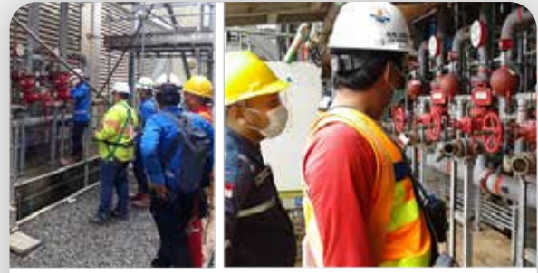
Inspeksi & pengujian Sistem Proteksi Kebakaran pada Tangki Minyak Pelumas – Area BTG Inspection & testing of Fire Protection System at Lube Oil System – BTG Area
