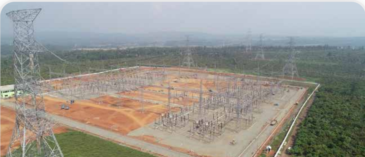
Gardu Induk Substation
